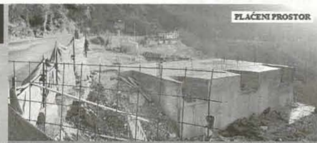
5. FEBRUAR 2017. POLAZNA STANICA ŽICARE ZIPLINE, POTKOPANA MAGISTRALA, AUTOBUSKO STAJALIŠTE, POLOMLJEN TROTOAR I OGRADA UZ MAGISTRALU, OPŠTINA BUDVA
